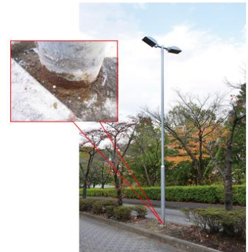
街路灯の腐食
